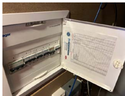
Sikringsskap i teknisk rom
