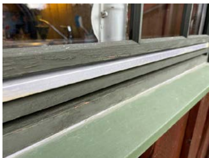
Vedlikeholdsbehov av enkelte vinduer
