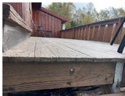
Skjevhet i terrasse
