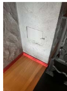
Manglende ubrennbar plate på gulv under sotluke
