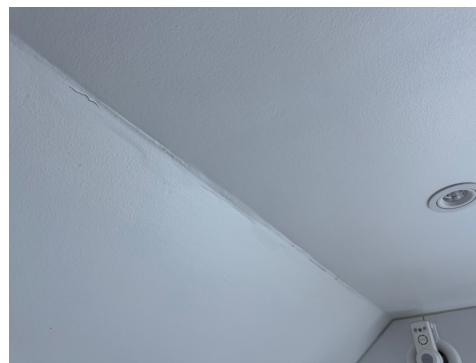
Foto viser sprekk/ riss i tak.
