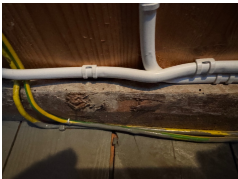
Foto viser flyvehull etter treinsekter i etasjeskiller.
