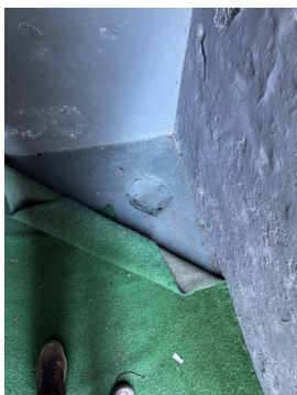
Foto viser sluk tildekket av teppe.
