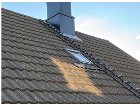
Foto viser beslag under takvindu som har sluppet fra takteking.
