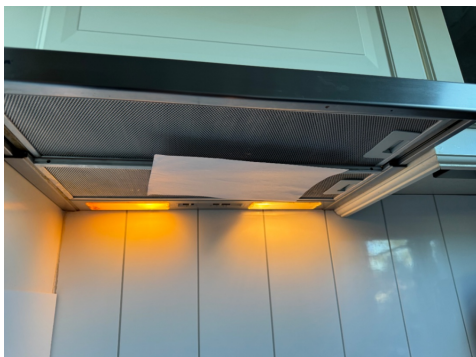
Foto viser test av avtrekk.
