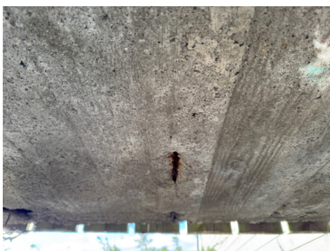
Foto viser synlig armering under veranda.
