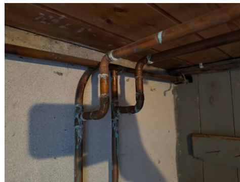
Foto viser irring kobberør anlegg.
