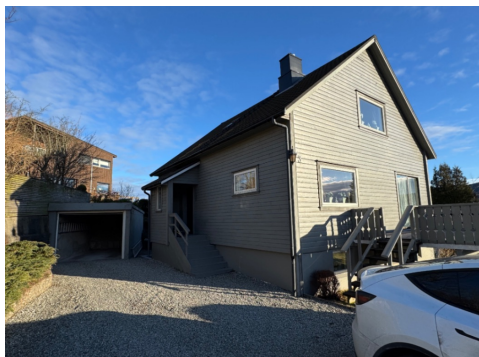
Foto viser manglende snøfangere på taket.
