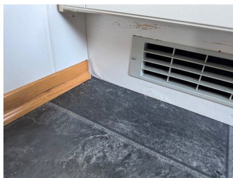
Foto viser svelling i sokkellist.
