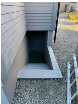
Foto viser manglende rekkverk og håndløper i trapp.
