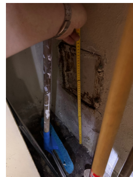
Foto viser avstand fra feieluke til gulvteppe er under 300 mm.
