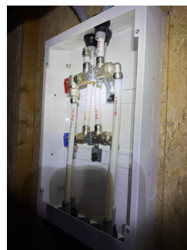
Foto viser rørskap for rør-i-rør system.
