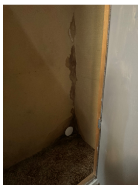
Foto viser fuktmerker på inv. veggflater.
