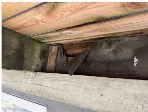
Foto viser lekte av 12x48 og utett papp under terrasse.
