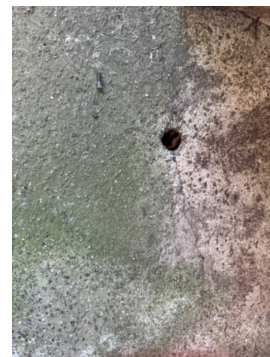
Foto viser hull i betong under veranda.
