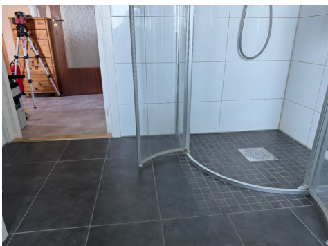
Foto viser oppkant ved dusj er høyere enn oppkant ved dør.
