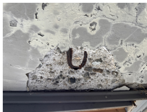
Foto viser synlig armering under overbygg.
