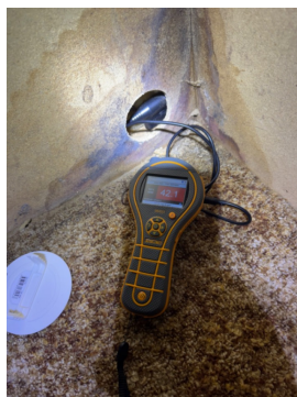
Foto viser saltutslag på inv. betongvegger.
