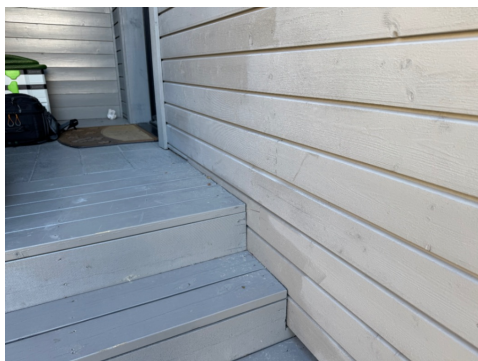
Foto viser riss/ sprekke i kledning ved inngangsparti. Liten lufting i nedre kant pga. terrassebord, forutsettes at lufting går opp bak trappetrinn.
