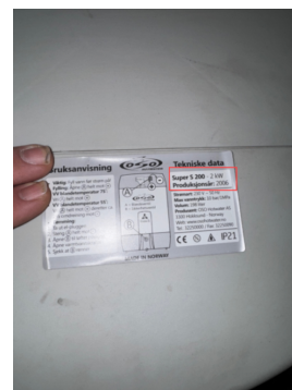
Foto viser alder på varmtvannstank.
