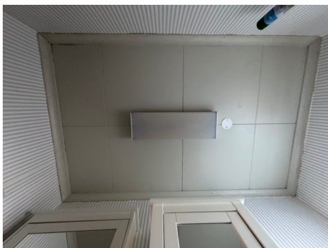
Foto viser ingen ventil i tak for avtrekk.
