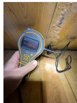
Foto viser noe soppspor i undertaket, 30,2 vekt% i trevirket og manglende lufting ute ved raft.
