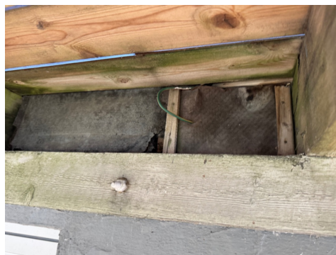
Joringskabel som kommer frem under terrasse.
