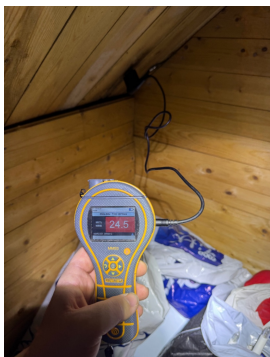
Foto viser 24,5 vekt% i undertak i kott, manglende lufting ved raft.
