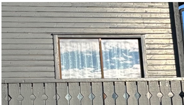
Foto viser riss/ sprekke i kledning på sør side.
