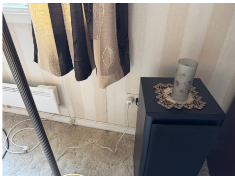
Innvendig observeres enkelte riss i tapet.
