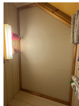
Foto viser ingen ventilasjon i tak/ vegg.
