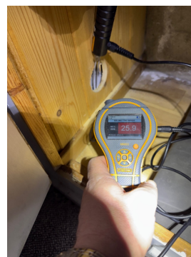
Foto viser fuktmåling i lukket vegg, 25.9 vekt%.
