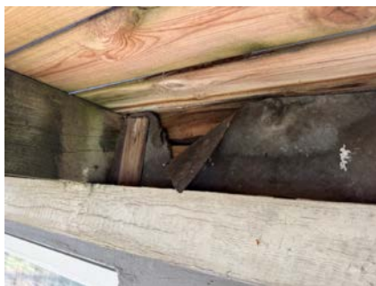
Foto viser lekte av 12x48 og utett papp under terrasse.
