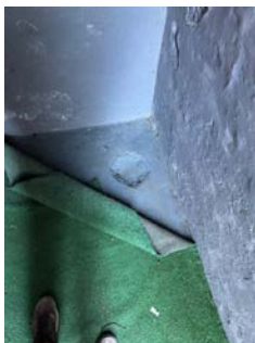
Foto viser sluk tildekket av teppe.
