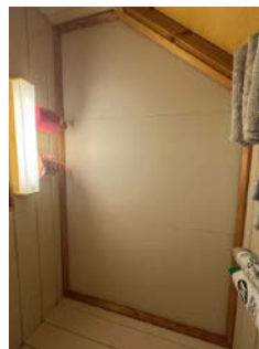
Foto viser ingen ventilasjon i tak/ vegg.
