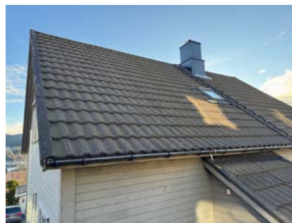
Foto viser mose/ grønske på takoverflate. Utett rundt mønestein.
