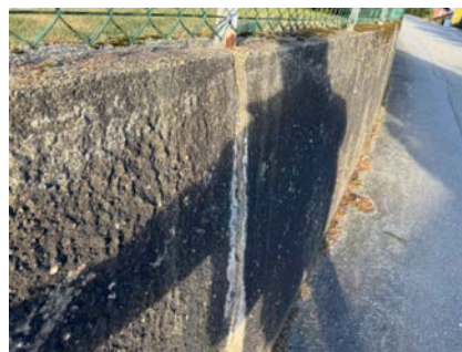
Foto viser spekk i støttemur, flere slike sprekker er observert, stedvis kontroll 1 - 2 cm.
