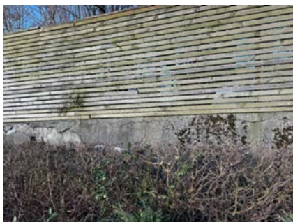
Foto viser endel riss/ sprekker i muren. Rekkverket har enkelte slitasjer i spiler.
