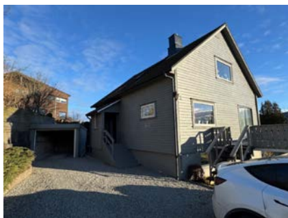
Foto viser manglende snøfangere på taket.
