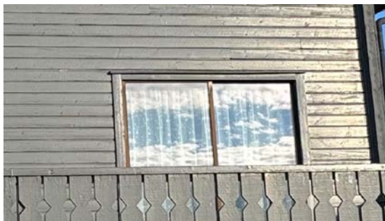
Foto viser riss/ sprekk i kledning på sør side.
