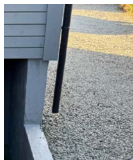
Nedløpsrør for tilbygg er avsluttet over bakke.
