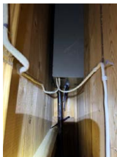
Synlig hull i skap under pga. ledninger som går inn og tidl. antenne.
