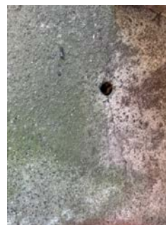
Foto viser hull i betong under veranda.
