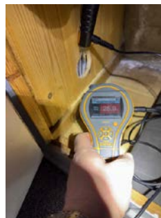
Foto viser fuktmåling i lukket vegg, 25.9 vekt%.
