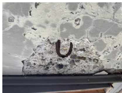
Foto viser synlig armering under overbygg.
