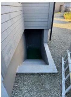
Foto viser manglende rekkverk og håndløper i trapp.
