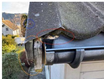
Hull i takfotbeslag (rød ring), sprekk i vindski (oransje ring) og rust i skrue (blå ring).
