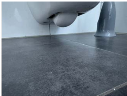
Ingen synlig spalte for lekkasjevann ved vegghengt toalett.
