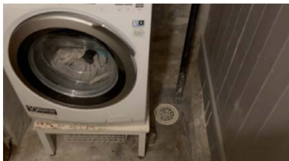
Foto viser saltutslag, manglende tettesjikt og sluk i våtrommet.
