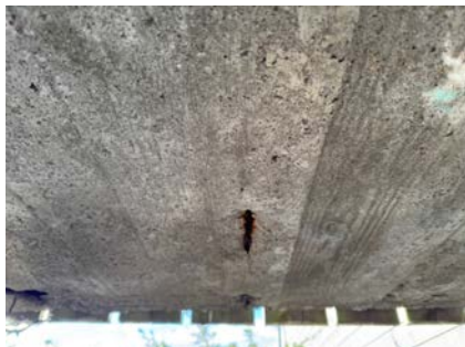
Foto viser synlig armering under veranda.
