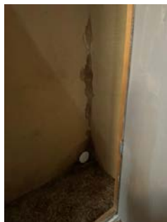
Foto viser fuktmerker på inv. veggflater.
