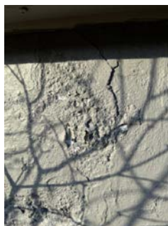
Påvist enkelte riss/ sprekker/ puss avskallinger rundt boligens grunnmur.
