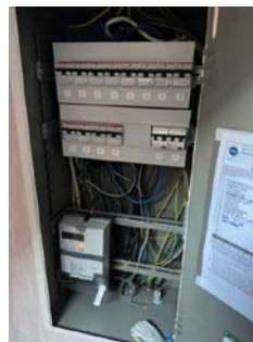
Foto viser innvendig sikringsskap.
