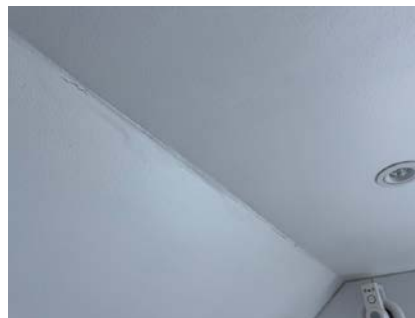
Foto viser sprekke/ riss i tak.
