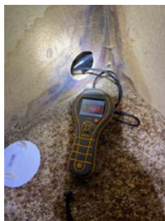
Foto viser saltutslag på inv. betongvegger.
