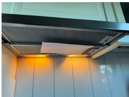
Foto viser test av avtrekk.
