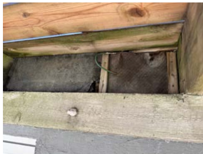
Joringskabel som kommer frem under terrasse.
