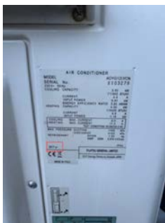
Utvendig varmepumpe, datoført 2017.
