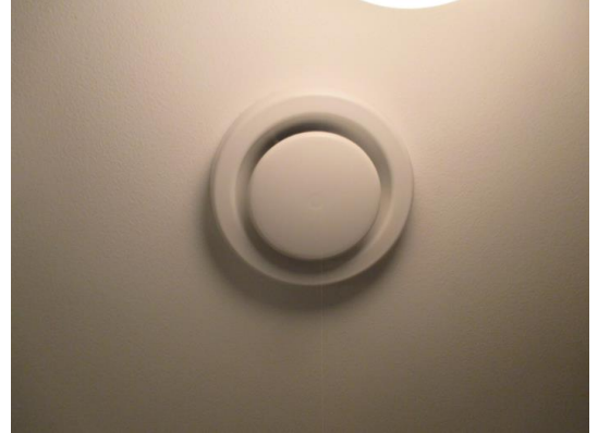
Avtrekk i himling.
