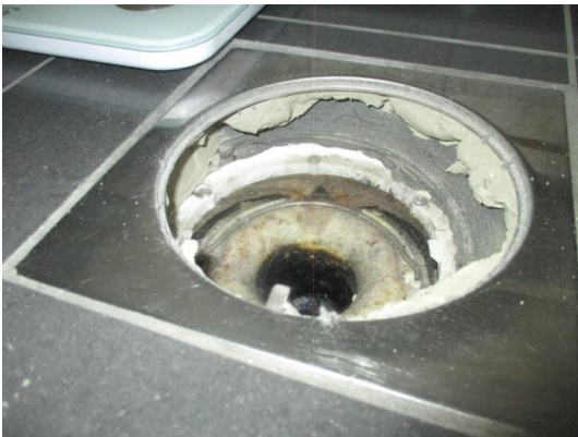
Sluk ved innredning.
