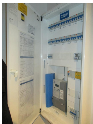
Sikringskapet er plassert i skyvedørgarderobe i hall.
