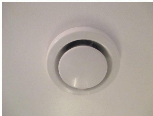
Avtrekk i himling.
