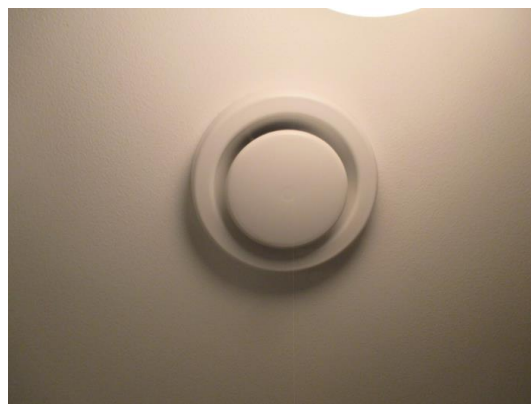
Avtrekk i himling.
