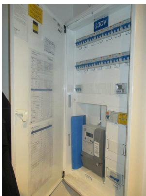
Sikringsskapet er plassert i skyvedørgarderobe i hall.
