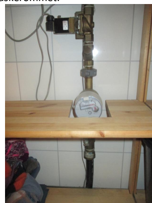
Innvendig stoppekran med vannmåler.
