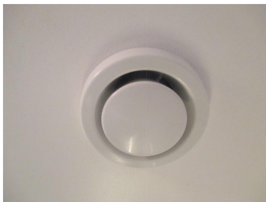
Avtrekk i himling.
