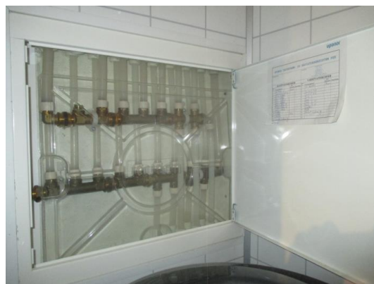
Fordelskap på vaskerommet.
