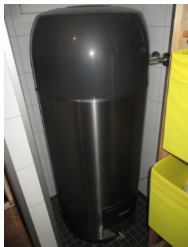
Bereder er plassert på vaskerommet.
