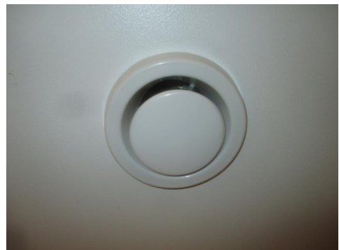
Avtrekk i himling.
