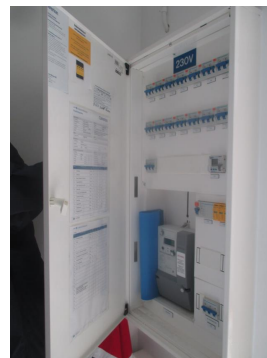
Sikringsskapet er plassert i skyvedørsgarderobe i hall.
