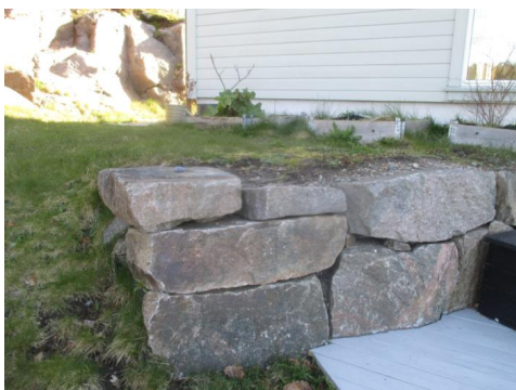
Skulle vært en sikring på toppen av mindre murer.
