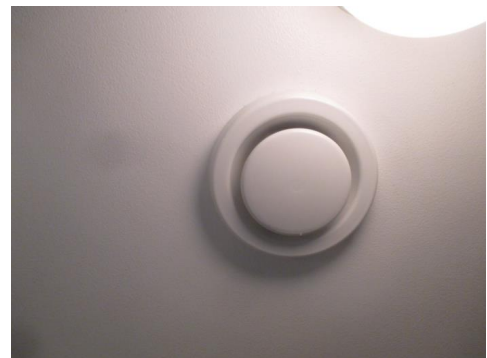
Avtrekk i himling.
