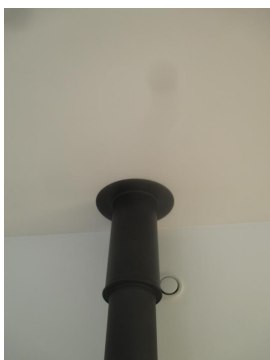
Isolert stålpipesom er ført over tak.
