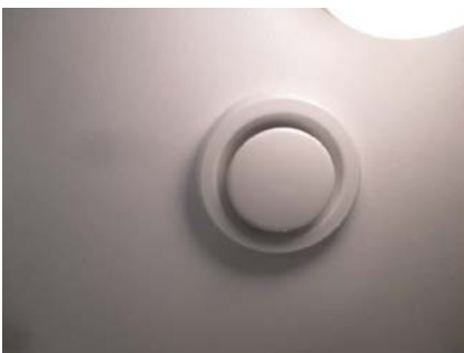
Avtrekk i himling.
