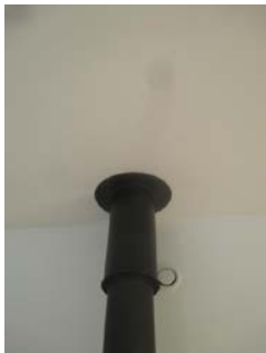
Isolert stålppe som er ført over tak.
