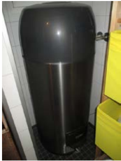
Bereder er plassert på vaskerommet.
