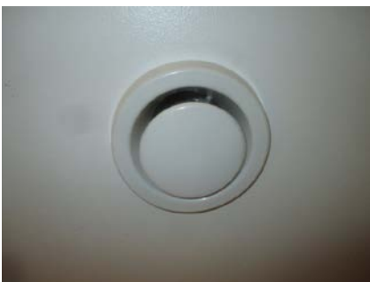
Avtrekk i himling.
