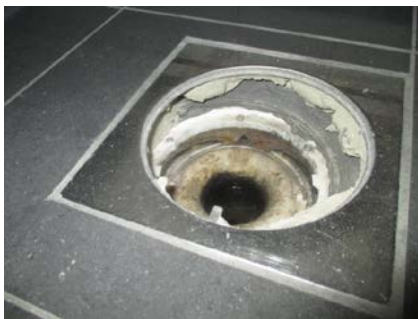
Sluk ved innredning.
