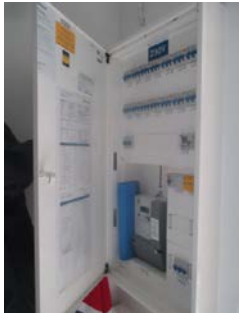
Sikringsskapet er plassert i skyvedørgarderobe i hall.
