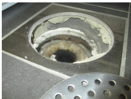
Sluk ved innredning
