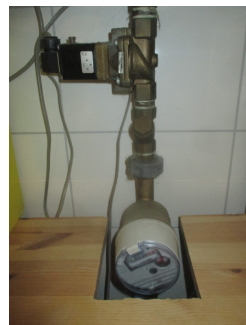
Innvendig stoppepekran med vannmåler.
