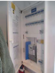
Sikringsskapet er plassert i skyvedørgarderobe i hall.
