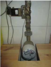
Innvendig stopppekran med vannmåler.
