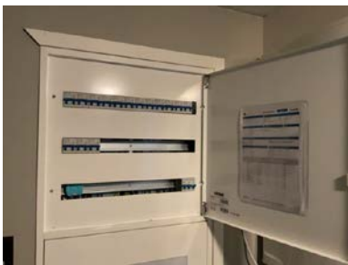
Sikringsskap plassert på teknisk rom. Anm: Manglende tildekking i skap er blitt montert i etterkant av befaring.
