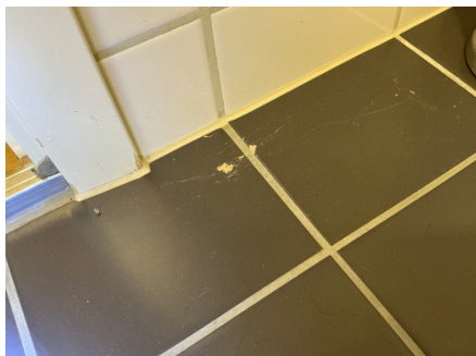
Skade på flis ved dør.
