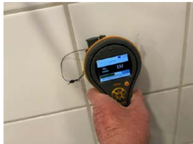
Ved fukt-søk under blandeblender er det ikke registrert unormale verdier.
