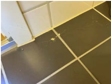
Skade på flis ved dør.
