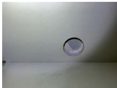
Ved hull-taking i seksjon på kjøkken er det brann-sjakt bak vegg og hull-taking er ikke gjennomført.
