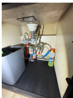
Endetetting av rør i rør system under utslagsvask anbefales.
