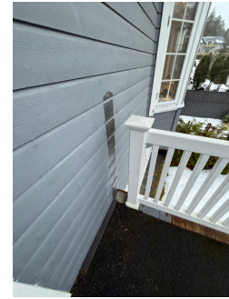
Lavt rekkverk og med for stor åpning inn mot yttervegg.
