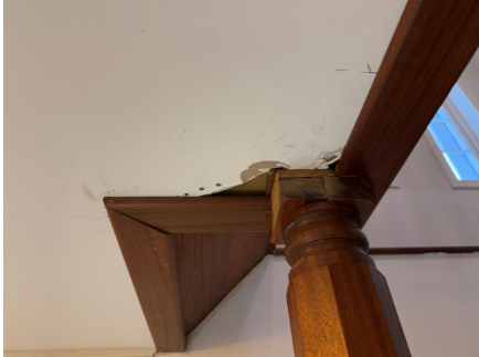
Noe gjenstående arbeider rundt søyle ved trapp hoveddel u. etg.
