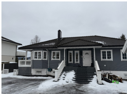
Trapp ved adkomst. Vedlikeholdsbehov av rekkverk.
