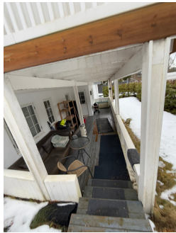
Terrasse med vedlikeholdsbehov. Merk at overbygg er ikke tett.
