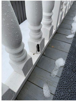
Råteskade i rekkverk mot syd samt lavt rekkverk.
