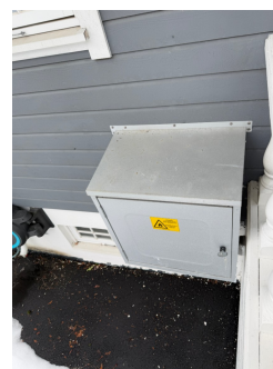
Gasskap på utsiden av kjøkken.
