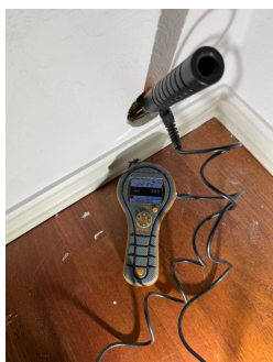
Noe høyde fuktverdier ble målt i den utforede veggen. Merk at det er fuktsperre i veggen.
