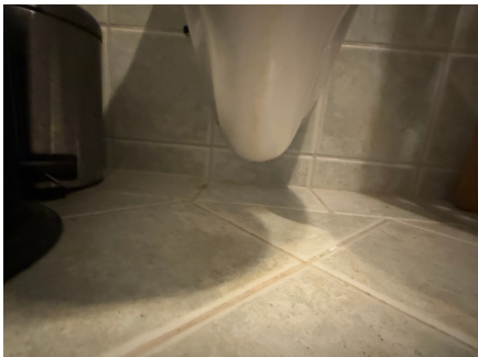
Ingen synlig drensåpning under vegghengt toalett.
