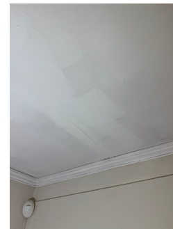
Vegger og tak med overflatebehandlingsbehov.
