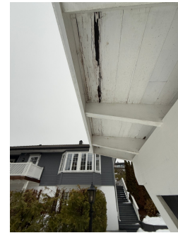
Råteskade i undertak overbygget del av terrasse.
