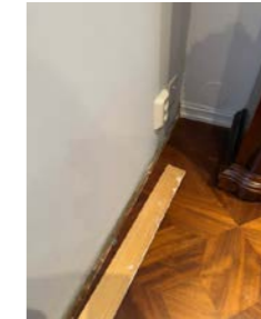
Noen løse lister ved reol stue 1. etg.
