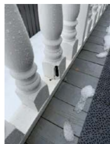
Råteskade i rekkverk mot syd samt lavt rekkverk.
