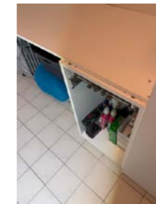
Mangler en dør på innredning.
