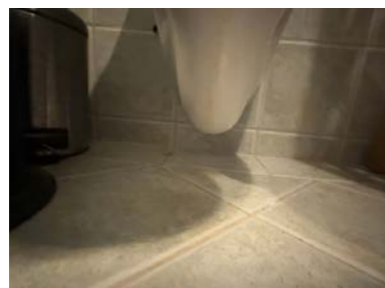
Ingen synlig dreinsåpning under vegghegt toalett.
