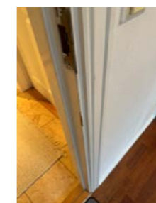
Mindre sårskade på innvendig dørkarm 1. etg.
