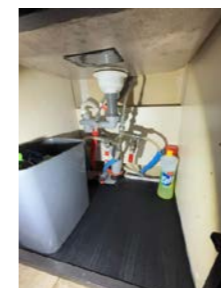
Endetetting av rør i rør system under utslagsvask anbefales.
