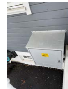
Gasskap på utsiden av kjøkken.
