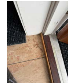
Riss i fliser ved hovedytterdør.
