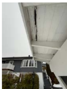
Råteskade i undertak overbygget del av terrasse.
