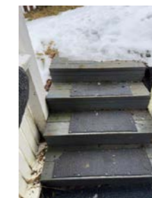
Vedlikeholdsbehov av trapp ved adkomst til separat del i o u. etg.
