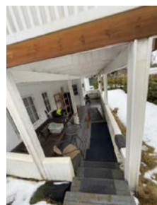
Terrasse med vedlikeholdsbehov. Merk at overbygg er ikke tett.
