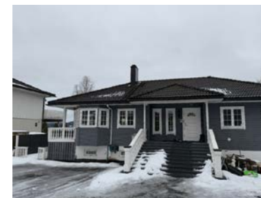
Trapp ved adkomst. Vedlikeholdsbehov av rekkverk.
