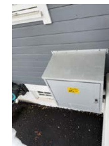
Gasskap på utsiden av kjøkken.
