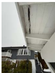
Råteskade i undertak overbygget del av terrasse.
