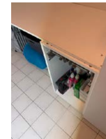
Mangler en dør på innredning.
