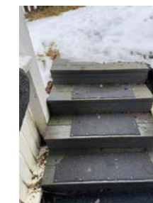
Vedlikeholdsbehov av trapp ved adkomst til separat del i u. etg.
