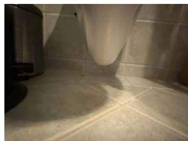
Ingen synlig dreinsåpning under vegghegt toalett.
