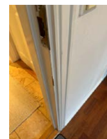
Mindre sårskade på innvendig dørkarm 1. etg.
