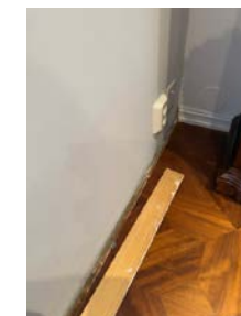
Noen løse lister ved reol stue 1. etg.
