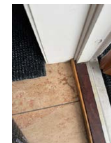
Riss i fliser ved hovedytterdør.
