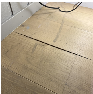
Parkett på soverom vest, toppsjiktet har løsnet.
