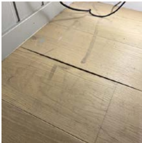
Parkett på soverom vest, toppsjiktet har løsnet.
