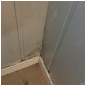
Svertesopp i hjørne på soverom øst
