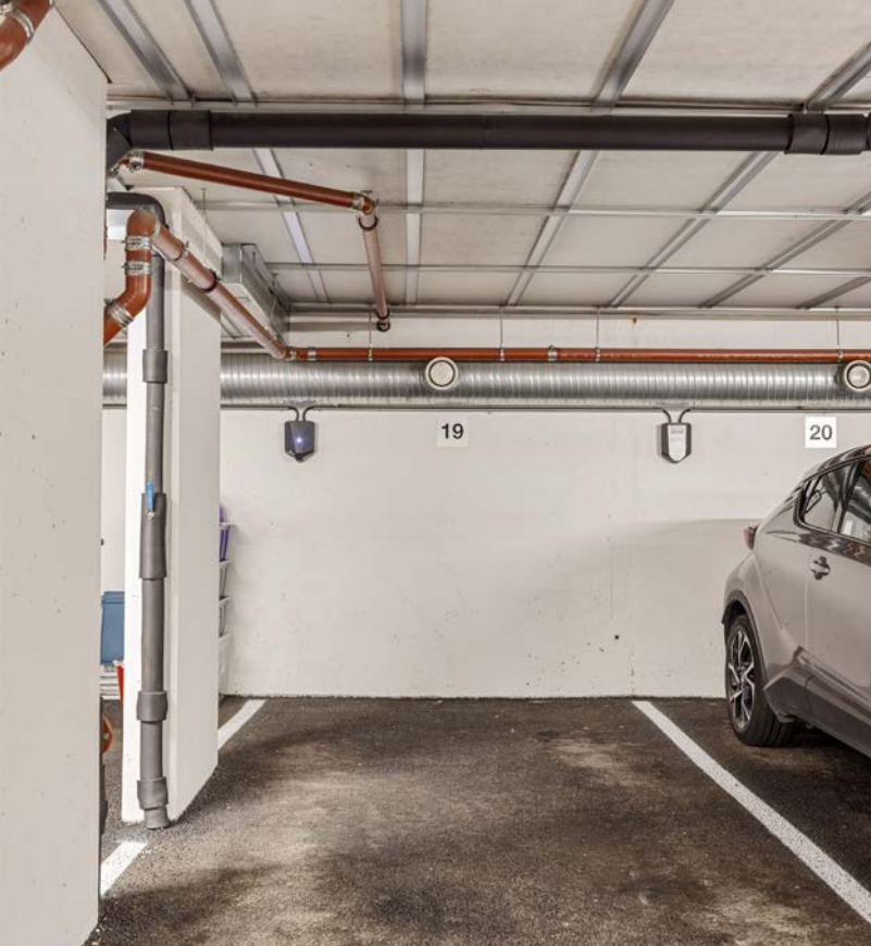
I tillegg disponerer leiligheten en garasjeplass med elbil-lader i felles garasjeanlegg i kjelleren.
