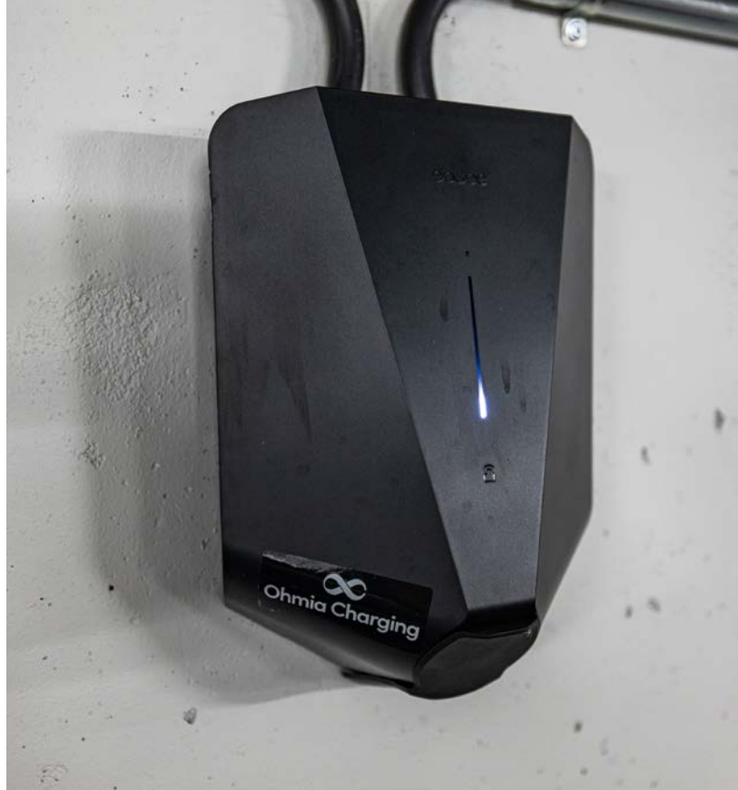
Det er montert elbil-lader.
