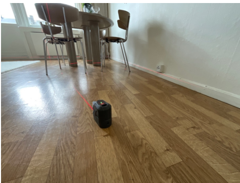
Nivellering stue, avvik ca. 10-20 mm
