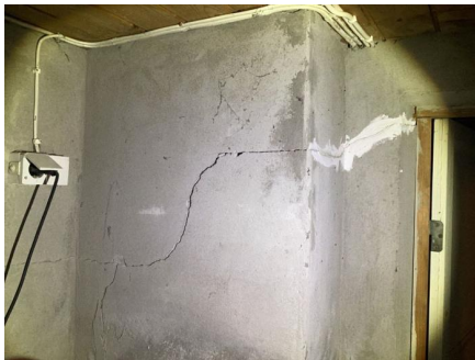
Eksempel på oppsprekking i grunnmur.
