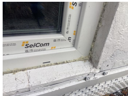
Forsegling rundt kjellervinduer er ikke ferdigstilt.
