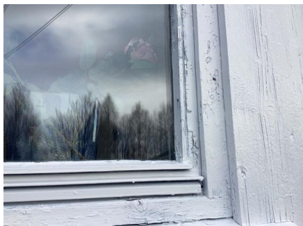
Eksempel på slitasje.
