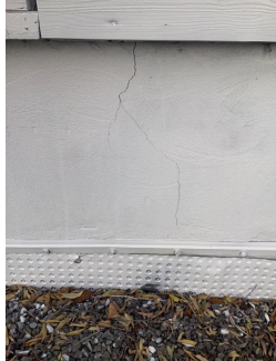
Eksempel på oppsprekking i grunnmur.
