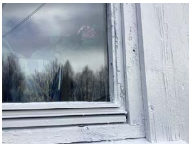
Eksempel på slitasje.
