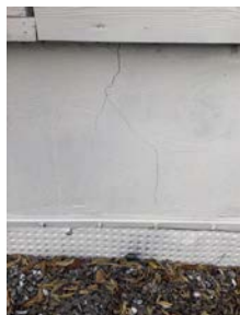
Eksempel på oppsprekking i grunnmur.
