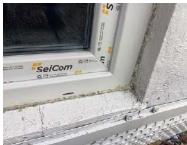
Forsegling rundt kjellervinduer er ikke ferdigstilt.
