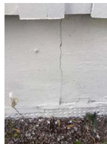
Eksempel på oppsprekking i grunnmur.
