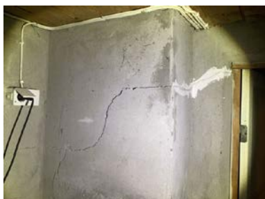
Eksempel på oppsprekking i grunnmur.
