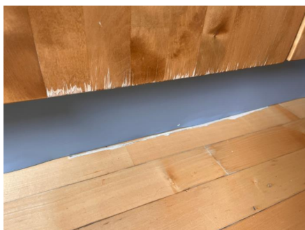
Skader i nedkant av skapdører.
