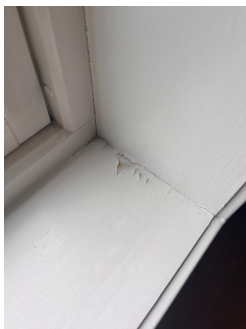
Maling på vindusforingen på kjøkken har løsnet.
