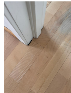
Dårlig tilpasset parkett og stor slitasje på soverom.
