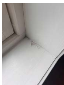
Maling på vindusforingen på kjøkken har løsnet.
