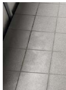
Misfargede fuger på åpen balkong.
