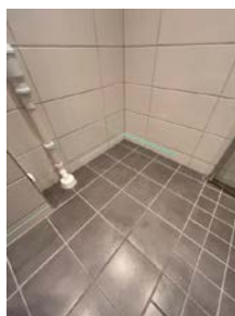
Rørgjennomføring i gulv ikke kontrollert
