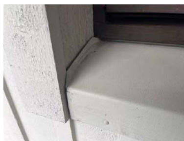
Oppbrett på beslag ligger utenpå kledningen.
