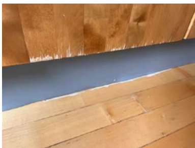
Skader i nedkant av skapdører.
