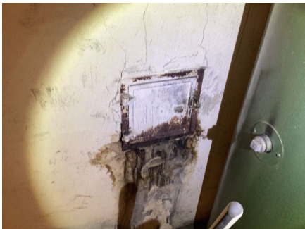
Rennemerker ved sotluke.
