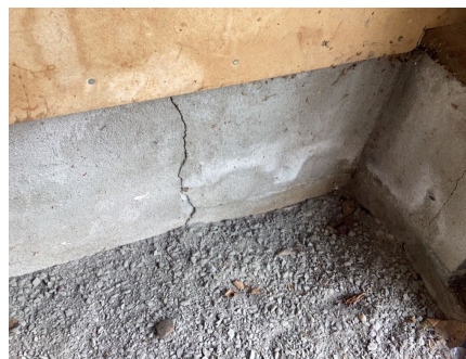
Eksempel på sprekke i grunnmur.
