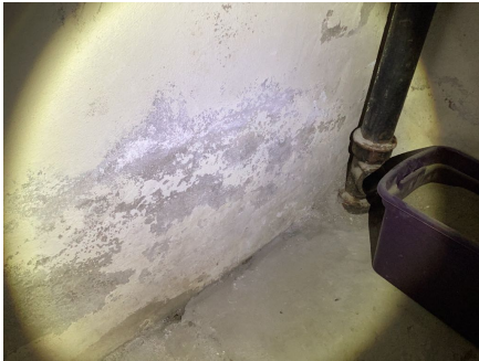
Eksempel på fuktpåkjenning på vegg.
