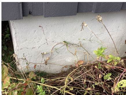
Eksempel på sprekke i grunnmur.
