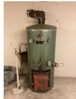
Eldre varmtvannsbereider som ikke lenger er i bruk.
