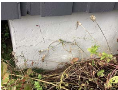
Eksempel på sprekke i grunnmur.
