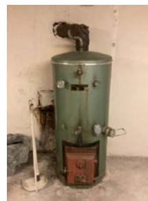
Eldre varmtvannsbereider som ikke lenger er i bruk.
