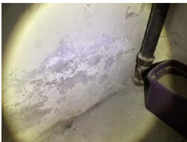
Eksempel på fuktpåkjenning på vegg.
