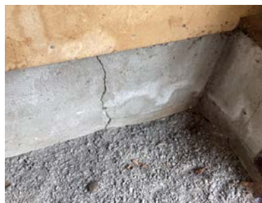
Eksempel på sprekke i grunnmur.
