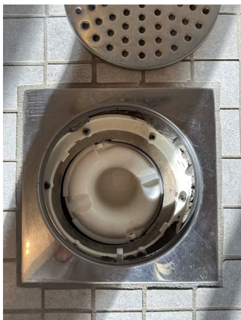
Viser sluk i dusjonen.
