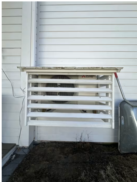
Viser varmepumpe utedel.
