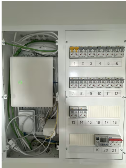
Viser sikringsskap plassert i teknisk rom.
