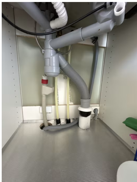
Viser vann og avløpsinnstallasjoner under kum.
