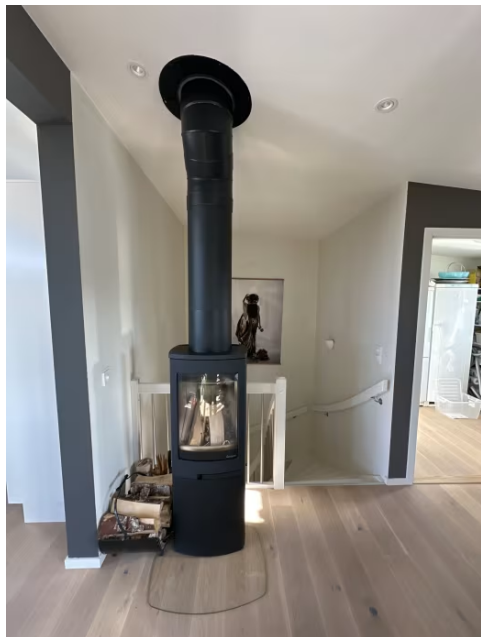
Viser peisovn montert i stue.
