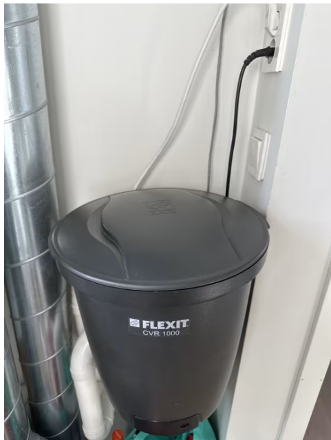
Sentralstøvsuger plassert på teknisk rom. Et uttak i hver etasje.
