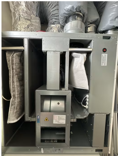
Viser aggregat innvendig.
