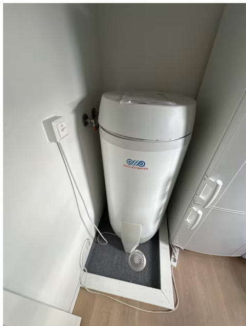
Viser bereder plassert på teknisk rom.
