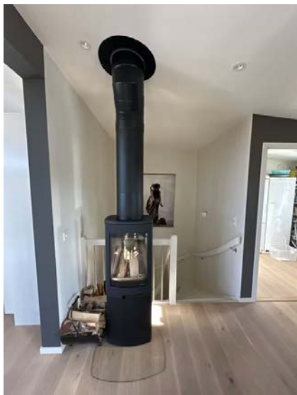
Viser peisovn montert i stue.
