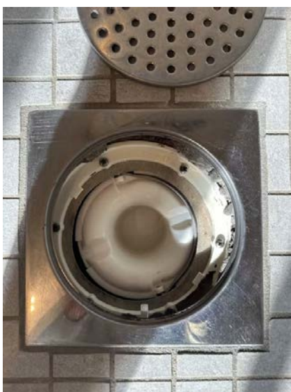
Viser sluk i dusjsonen.
