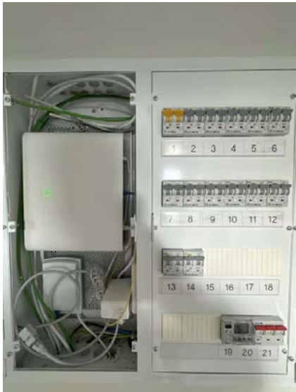
Viser sikringsskap plassert i teknisk rom.
