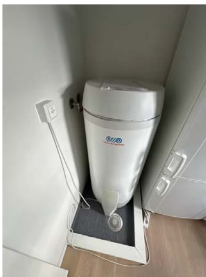
Viser bereder plassert på teknisk rom.
