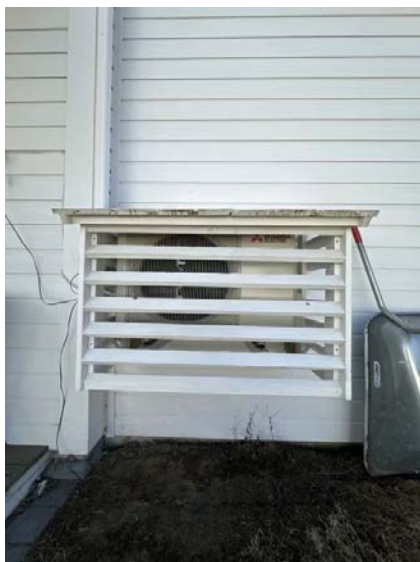
Viser varmepumpe utedel.
