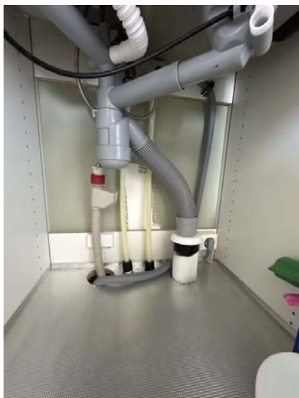
Viser vann og avløpsinnstallasjoner under kum.
