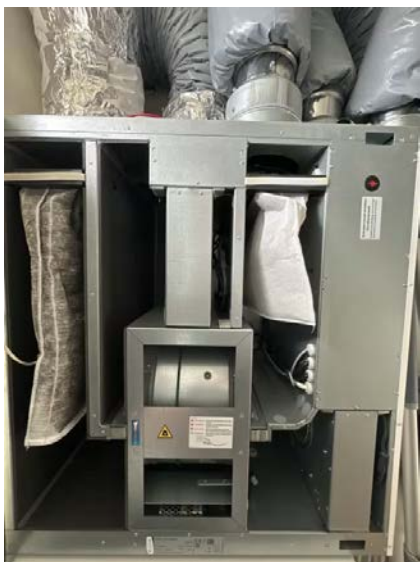
Viser aggregat innvendig.
