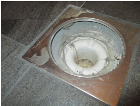
Sluk under dusjkabinett.
