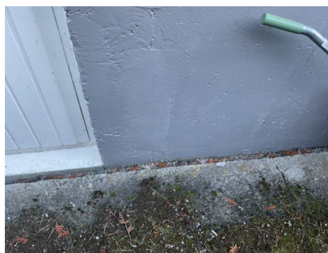
Fuktsikring er ikke synlig.
