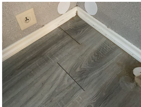
Fukt i vegg ved bad leilighet
