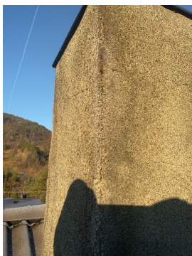
Riss og sprekker på puss over tak.
