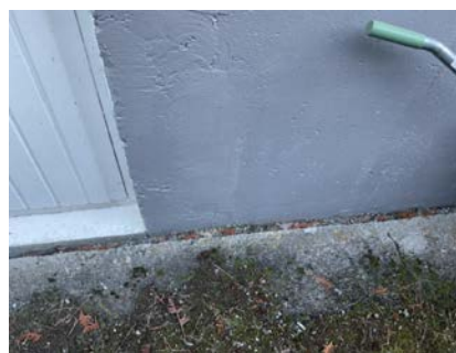
Fuktsikring er ikke synlig.
