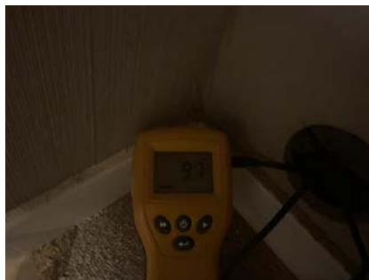
Tørt i vegg ved trapp
