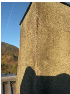
Riss og sprekker på puss over tak.
