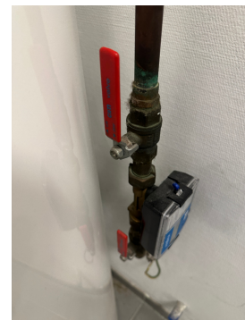
Stoppekranner plassert på vaskerom
