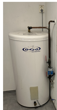
Varmtvannsbereder plassert på vaskerom
