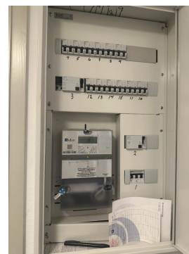
Sikringsskap med automatsikringer.
