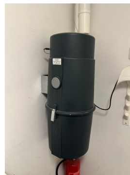
Sentralstøvsuger plassert på vaskerom
