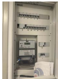
Sikringsskap med automatsikringer.
