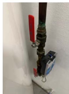
Stoppekraner plassert på vaskerom
