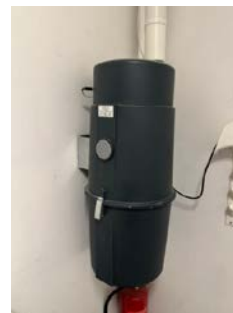
Sentralstøvsuger plassert på vaskerom
