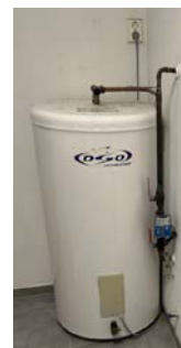
Varmtvannsbereider plassert på vaskerom
