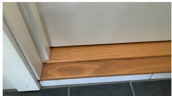
Tilluft ved dør
