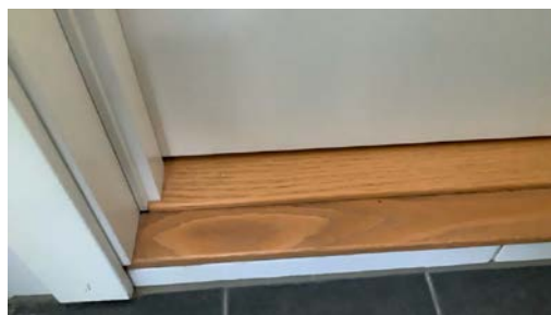
Tilluft ved dør
