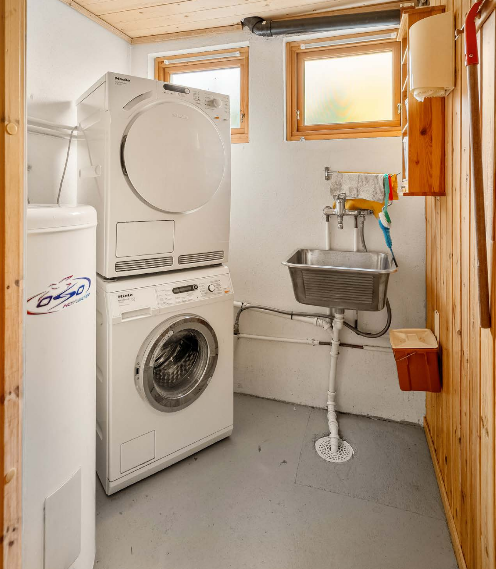
Vaskerom u. etasje
