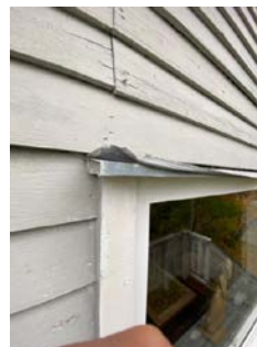
Det er påvist spredte råteskader i bordkledningen.
