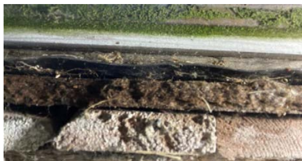
Manglende lufting gir økt risiko for fuktskader i konstruksjonen.
