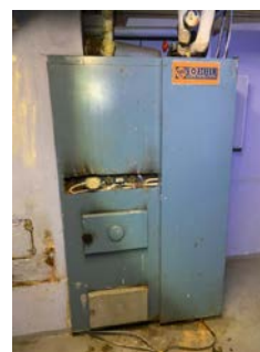
Varmtvannsbereder fra byggeår.
