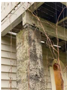
Ikke fagmessig opplegg på søyler.
