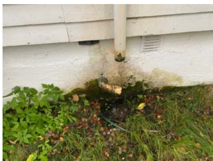
Stående vann mot mur.
