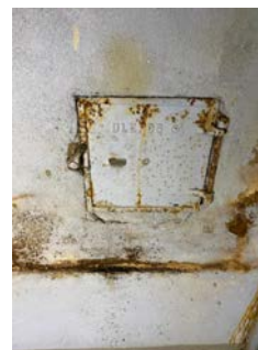
Sotluke plassert på vaskerom i kjeller.
