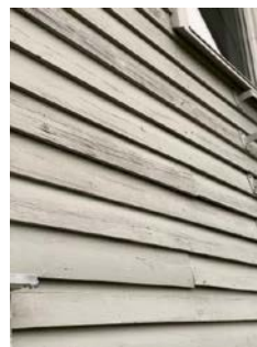
Det er påvist spredte råteskader i bordkledningen.
