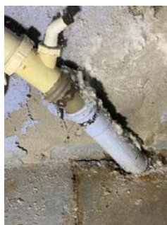
Soil (jernrør) på vaskerom i kjeller.
