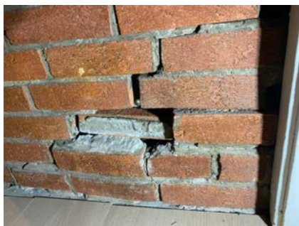
Riss og sprekker i mursteinpipe, loftsetasje.
