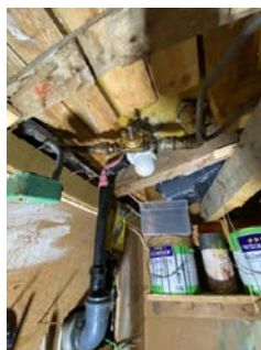
Vann og avløp fra bad i 2. Etg, sett fra bod i 1. Etg.
