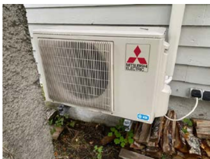
Utvendig del varmepumpe 2.
