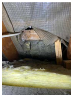
Utett rørgjennomføring mot undertak.
