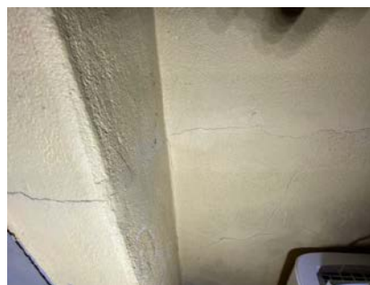
Horisontal riss i grunnmur i kjeller.
