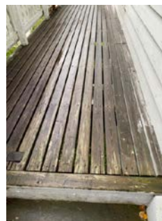
Råteskader/opsprukket treverk i terrasedekket.
