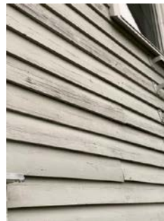
Det er påvist spredte råteskader i bordkledningen.
