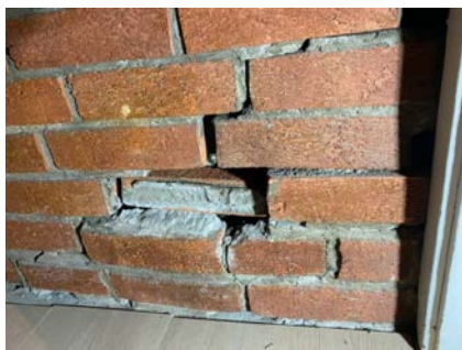
Riss og sprekker i mursteinpipe, loftsetasje.
