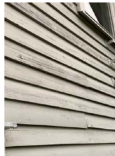
Det er påvist spredte råteskader i bordkledningen.
