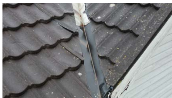
Gradrenne: malingsavflassing, rust og løse decrapanner.
