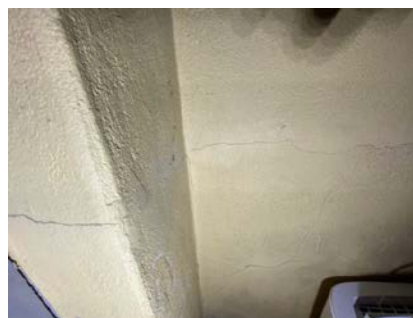
Horisontal riss i grunnmur i kjeller.
