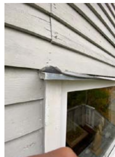
Det er påvist spredte råteskader i bordkledningen.
