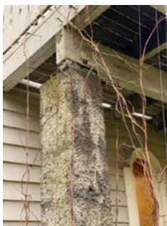
Ikke fagmessig opplegg på søyler.
