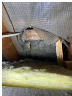
Utett rørgjennomføring mot undertak.
