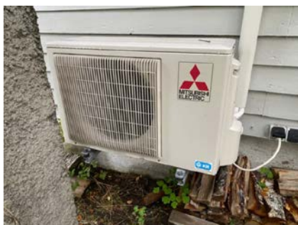
Utvendig del varmepumpe 2.
