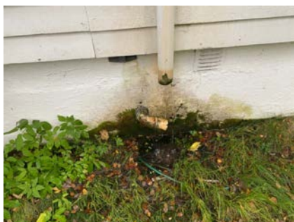
Stående vann mot mur.
