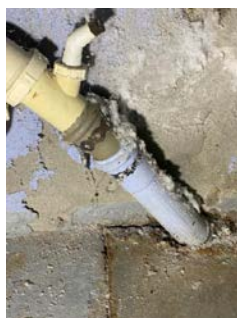
Soil (jernrør) på vaskerom i kjeller.
