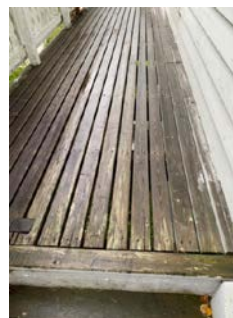
Råteskader/oppsprukket treverk i terrasedekket.
