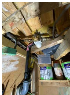
Vann og avløp fra bad i 2. Etg, sett fra bod i 1. Etg.
