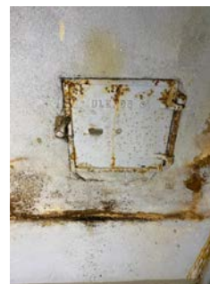
Sotluke plassert på vaske rom i kjeller.
