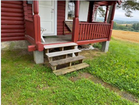
Trapp kjøkkeninngang uten rekkverk.
