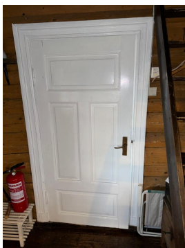
Dører til kjøkken og soverom tar i karmen/terskler.
