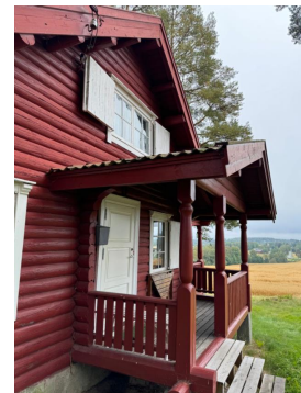
Ingen takrenner eller beslag mot vegg
