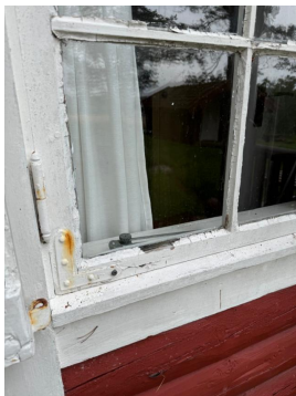
Vinduer har behov for vedlikehold
