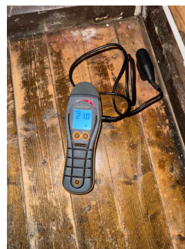
Forhøyede fuktverdier målt i stuegulv over krypkjeller uten tilgang.
