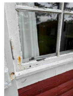
Vinduer har behov for vedlikehold
