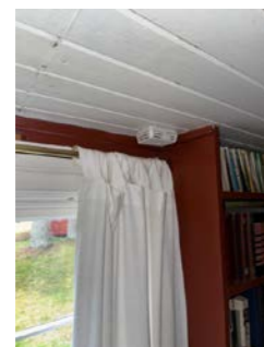
Ikke fungerende røykvarslere 1.etg.
