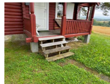
Trapp kjøkkeninngang uten rekkverk.
