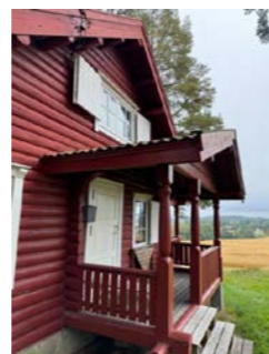
Ingen takrenner eller beslag mot vegg
