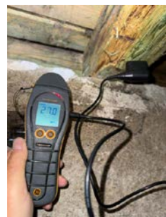
Etasjeskiller med forhøyede fuktverdier (27 vektprosent) mellom kjeller og soverom/kjøkken
