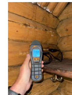
Forhøyede fuktverdier og fuktmerker på innvendige stokker i hjørnet mot kjøkken.
