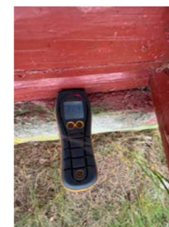
Unormale fuktverdier i bunnstokk.
