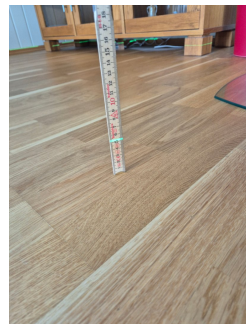
...til 5,1 cm over en lengde på 2 meter i stue.
