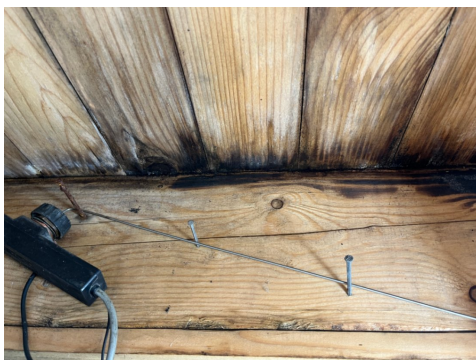
Fukt/råteskade i undertak.
