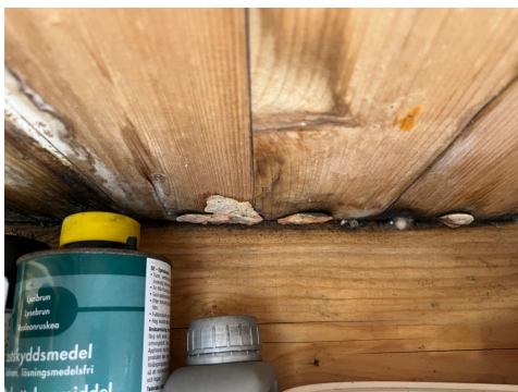
Råteskade og sopp i undertak
