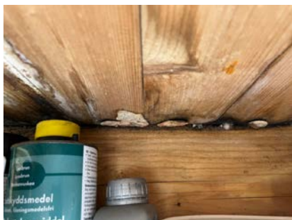
Råteskade og sopp i undertak
