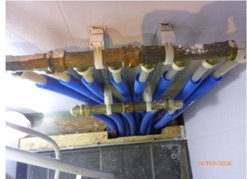
Ved opplegg for vaskemaskin.
