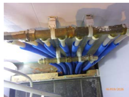
Ved opplegg for vaskemaskin.
