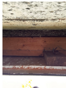
Manglende lufting bak kledning
