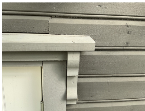
Manglende spalte mellom kledning og vannbrettbeslag
