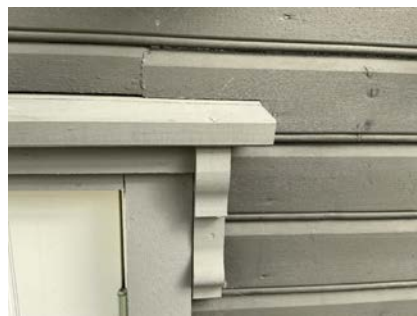
Manglende spalte mellom kledning og vannbrettbeslag
