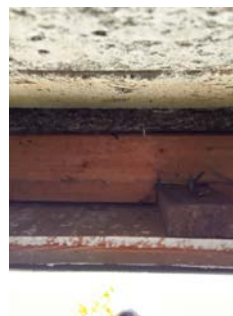
Manglende lufting bak kledning
