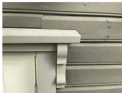
Manglende spalte mellom kledning og vannbrettbeslag
