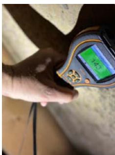
Ingen fuktighet under muggsopp
