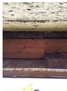
Manglende lufting bak kledning
