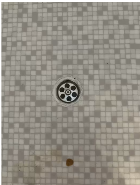
Viser sluk i dusjsone.
