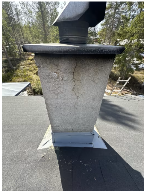
Det registreres sprekker i pipe.
