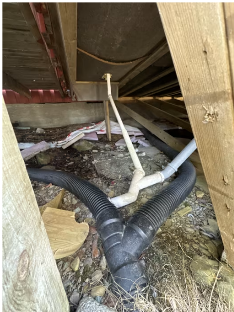
Plastrør/slanger under hytta til filtrering i grunnen.
