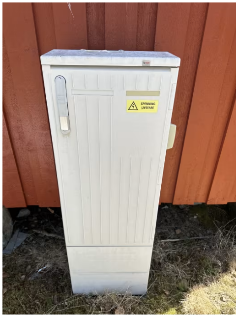
Viser utvendig målerskap.
