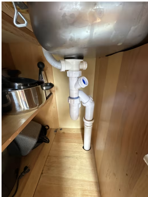
Viser avløpsinnstallasjoner under kum.
