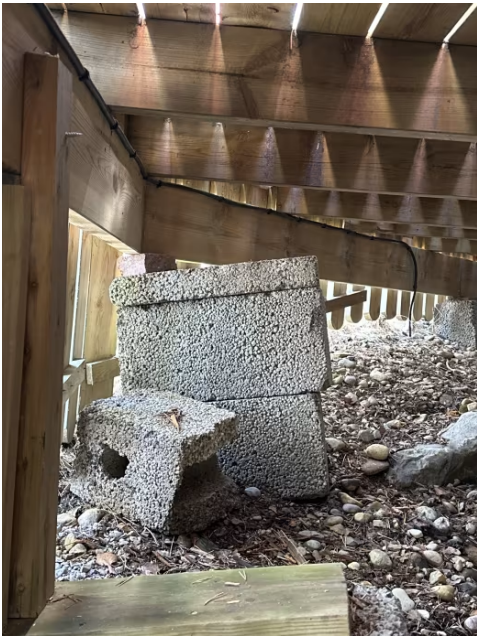
Fundament har konstruksjonssvikt og er underdimensjonert.
